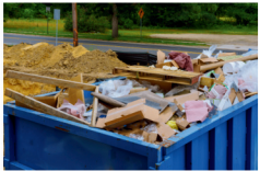
Residuos de construcción
